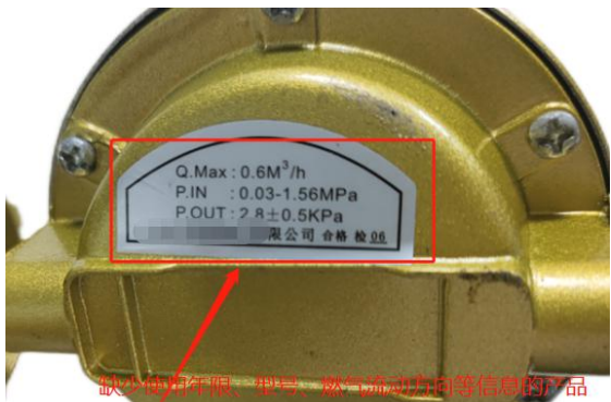
标志不全的调压器
